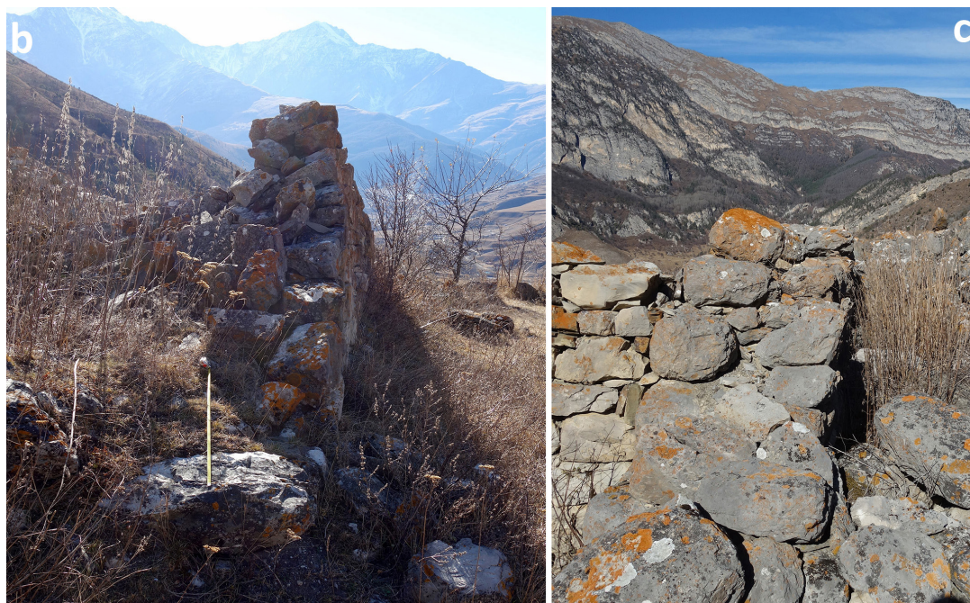
Рис. 3. Деформации стен субмеридиональной ориентировки: а – восточная стена ганах, вид на юг, т. 4. б – стена на западной окраине центрального комплекса сооружений, вид на юг, т. 5. с – стена на юго-западной окраине центрального комплекса сооружений, вид на север, т. 6 / Fig. 3. Deformations of walls of submeridional orientation: a – eastern wall of the ganakh, view to the south, p. 4. b – wall on the western edge of the central complex of buildings, view to the south, p. 5. c – wall on the southwestern outskirts of the central complex of buildings, view to the north, p. 6
