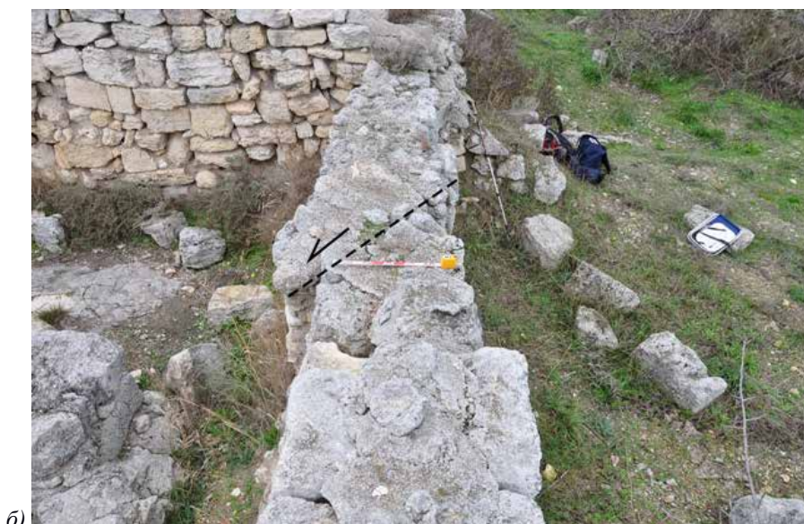
Рис. 2. Деформации стен внутреннего фасада усадьбы XI–XIII вв. в VI квартале Херсонеса (Северо-восточный район города, к северо-западу от главной улицы). (а) схематический план части двора усадьбы XI–XIII вв. в VI квартале с нанесенными на него образцами деформации; цифры в кружочках: 1–4 – выкалывания и выдвигания стен к ССВ, 5 – поворот нижней части стены против часовой стрелки на 12^\circ , 6 – сквозная трещина, пробивающая два крупных античных блока вторичного использования подряд. (б) Вид на одну из сколовых трещин сверху. Простирание трещины – 175^\circ , общее простирание расколотой стены – 120^\circ , простирание обоих фрагментов стен близ скола – 126^\circ , смещение по сколу – до 30 см. Снято с юго-востока.
