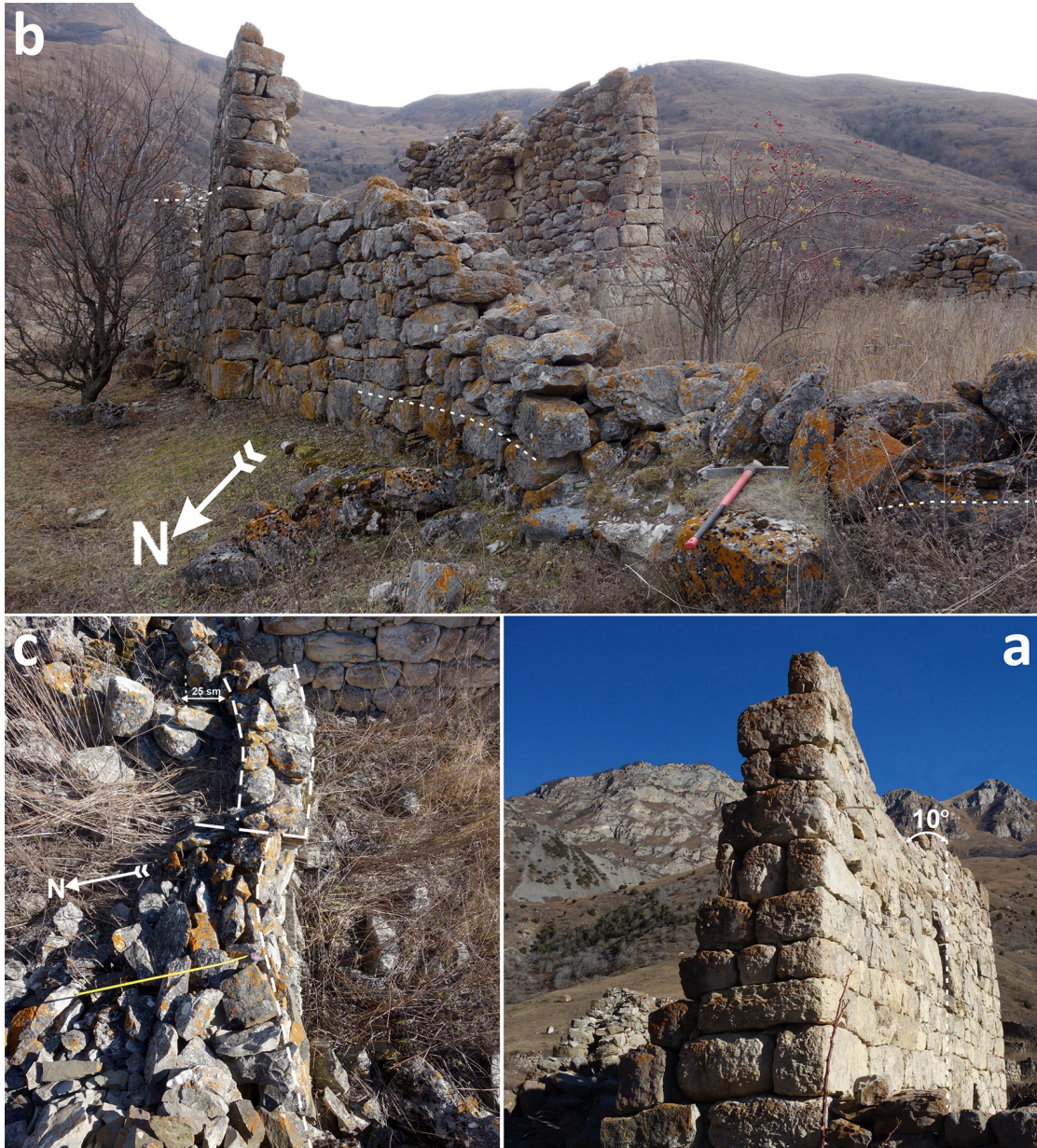
Рис. 2. Деформации стен субширотной ориентировки.
