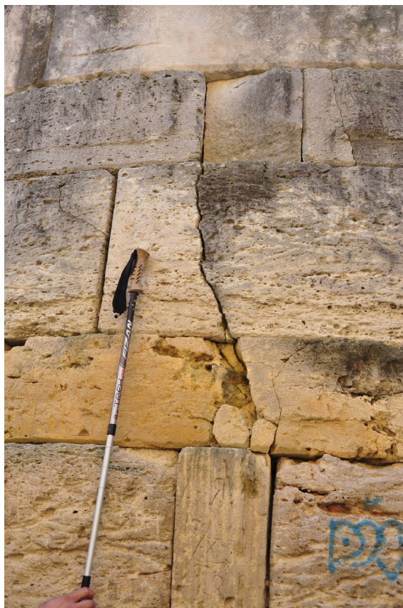
Рис. 5. Сквозная трещина в башне Зенона, пробивающая два каменных блока подряд.
