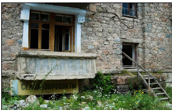
Один из домов бельгийской постройки. Первый этаж полностью засыпан селевым потоком. Вывеска магазина оказалась на уровне ног.
