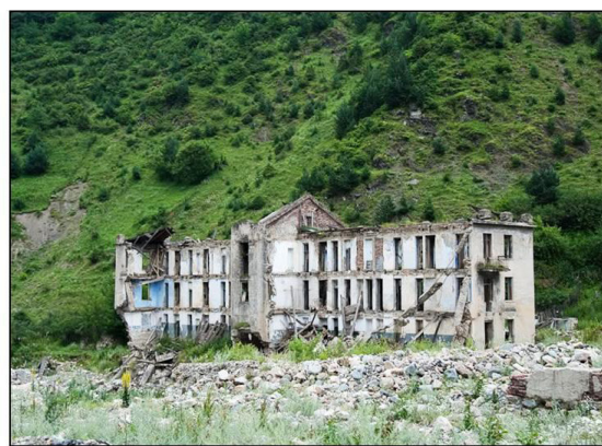
Корпус бывшей конторы ГРП. Селевой поток отломил и унес треть здания.
