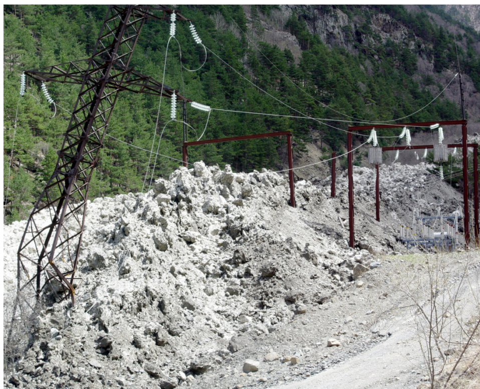
Рис. 4. Электростанция в Касайкоме, заваленная лавиной в апреле 2005 г. (фото Р. Тавасиева)
