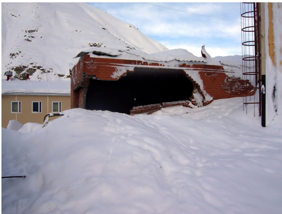
Рис. 10. Разрушенная котельная военного городка Рокского тоннеля в январе 2013 г. (фото Шамиля Сулейманова)
