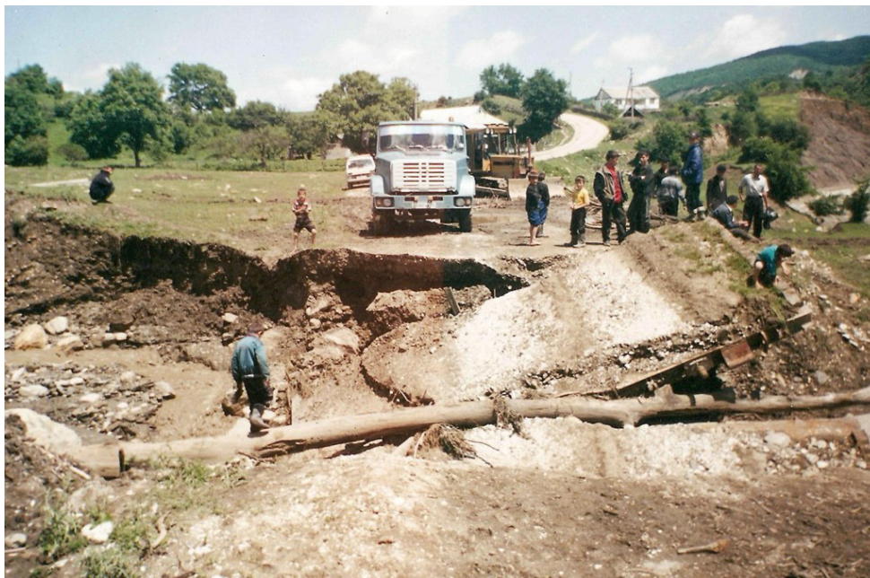
Рис. 1. Оползень, разрушивший автодорогу и возникший в результате Курчалойского землетрясения 11 октября 2008 г. с K_p = 14,5 , M_w = 5,8 , I_0 = 7-8 [Гайсумов, 2014]
