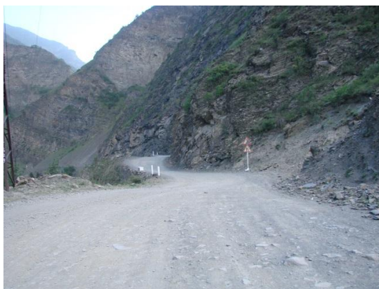
Рис. 2. Типичный оползневой склон / Fig. 2. Typical landslide slope
